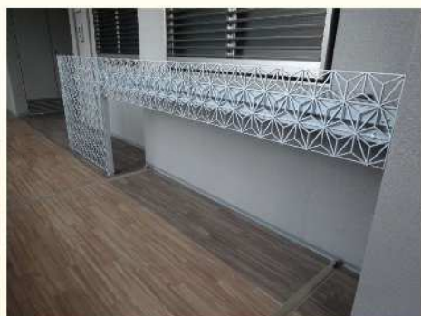
エアコンの室外機置場。
